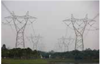
▲반트 주 땅으랑 지역의 송전탑 (사진: 자카르타경제신문)
