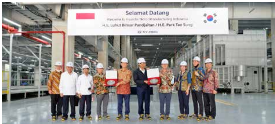
박태성 대사는 루투 해양투자자정부 장관과 함께 지난해 2020년 11월 6일 자카르타 인근 델타마스 공단내 현대자동차 공장 건설 현장을 방문했다. <사진 한국대사관>
